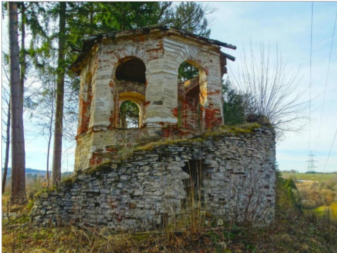
Abb. 5.46: Zustand der Teufelskirche im Mai 2023 (Ost-Ansicht). Quelle: R. Zappe, 2023.
