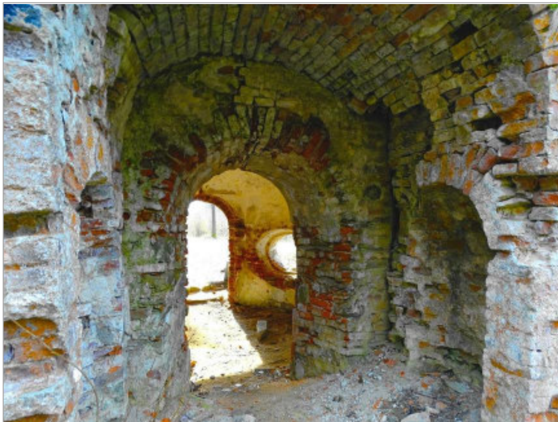
Abb. 5.53: Zustand der Teufelskirche im Mai 2023 (Eingangsbereich im Norden). Quelle: R. Zappe, 2023.
